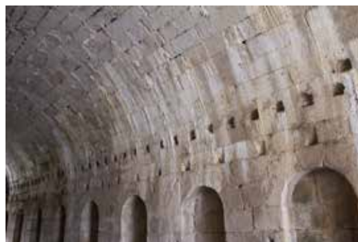
Fig. 6 Registo do interior da abóbada de berço no Trânsito da Porta Interior de Santo António com evidentes manifestações de perda de estanqueidade (foto RL). / Fig. 6 Registration of the interior of the barrel vault in the Transit of the Inner Gate of S. António with clear evidence of loss of watertightness (RL photo).
