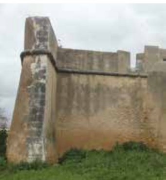
Figura 18. Flanco e orelhão recto de um baluarte da muralha urbana de Lagos. / Straight flank and orillion of the bulwark of the urban wall of Lagos.
